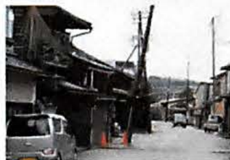
伏木地区では液状化現象で電柱が沈み傾いた
